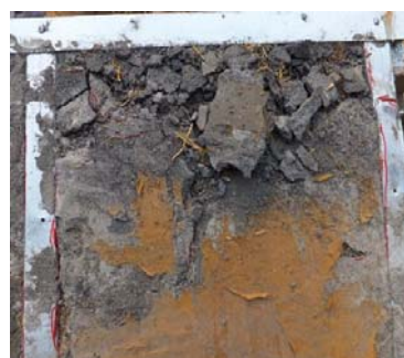
(d) Brittle failure of W-3 FC
